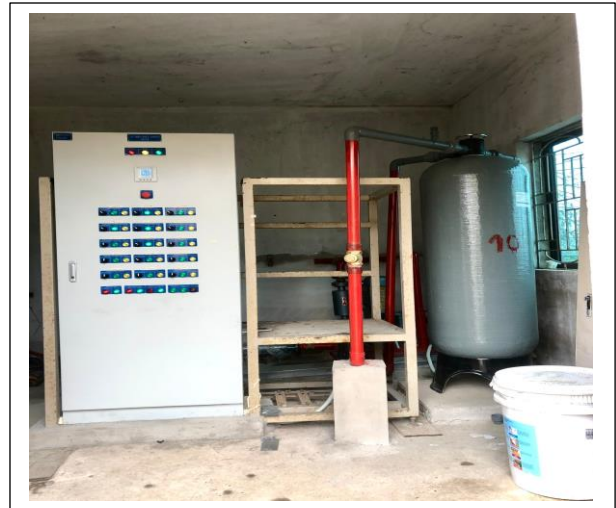
Hình 3.10. Hệ thống tủ điện và bồn lọc áp lực
