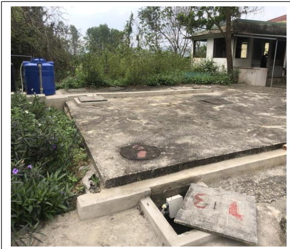
Hình 3.9. Khu xử lý nước thải
