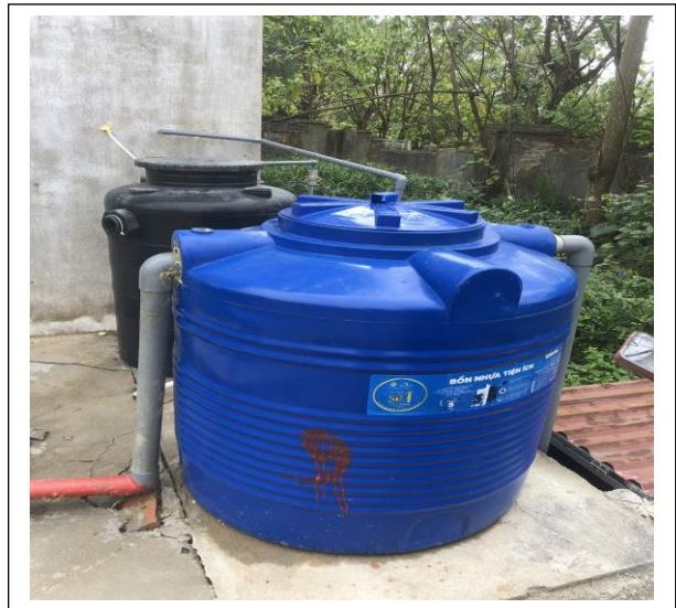
Hình 3.11. Bể khử trùng
