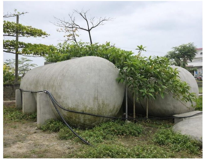
Hình 3.7. Hệ thống xử lý nước thải hiện trạng
