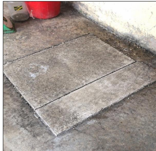
Hình 3. 6 Bể tách dầu mỡ tại cơ sở
