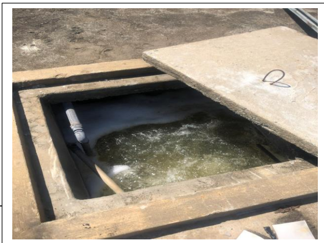
Hình 3.8. Bể hiếu khí
